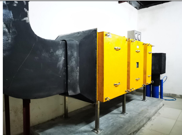
放射性废气吸附塔
